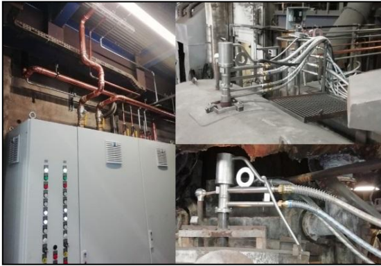
Effiziente Oxy-Fuel Brennerstation im Schmelzbetrieb (2019)
